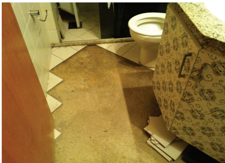
Figura 4: Estrago no piso do banheiro
