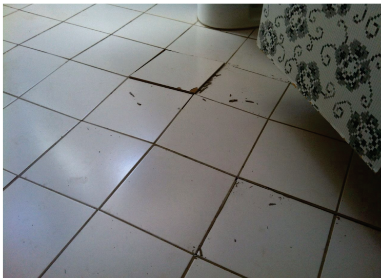
Figura 3: Efeitos físicos no piso de cerâmica do banheiro
