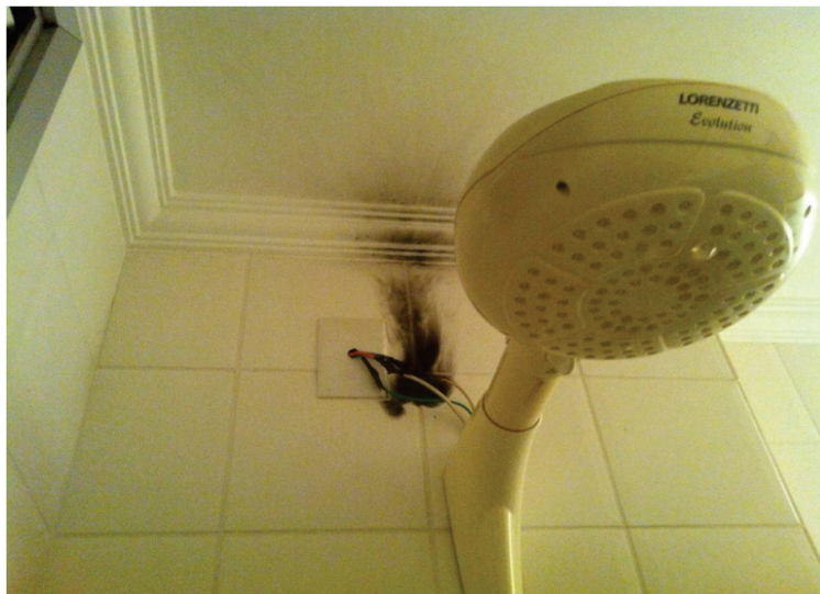
Figura 2: Chuveiro após fogo na fiação
